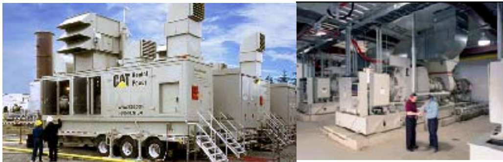
Turbinas de Gas pequeñas.
