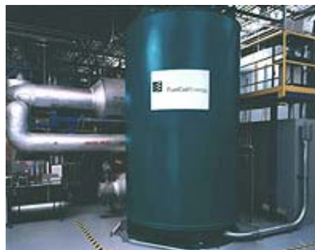
Celda de Combustible.
